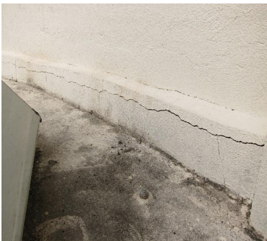
Foto 24 – Formação de trincas no reboco da viga
