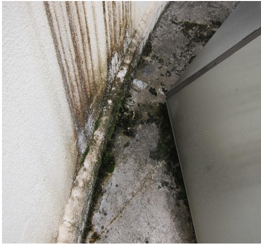
Foto 18 – Formação de fungos na estrutura
