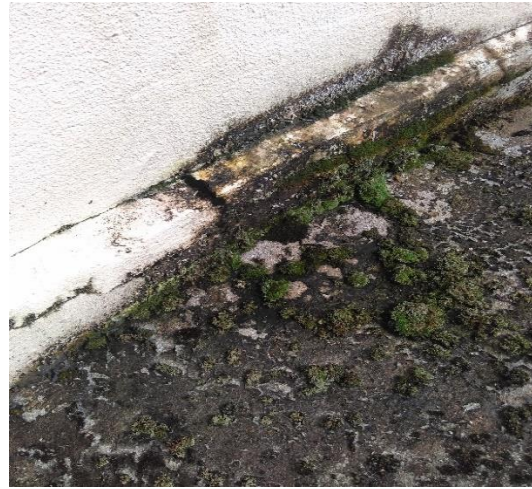
Foto 19 – Detalhe da formação de fungos na estrutura
