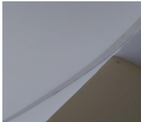
Foto 37 – Descolamento do gesso abaixo da estrutura
