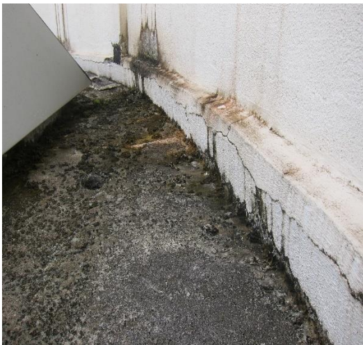
Foto 20 – Presença de umidade e formação de trincas no reboco das vigas
