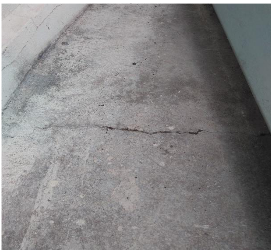
Foto 26 – Formação de fissuras na cobertura cimentícia da laje
