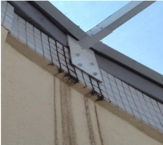
Foto 14 – Detalhe de infiltração de água Pela cobertura da cúpula
