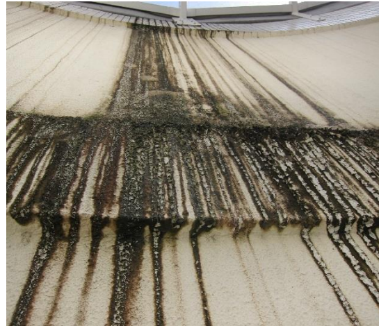
Foto 15 – Infiltração de águas pluvias nas alvenarias e na cinta de concreto
