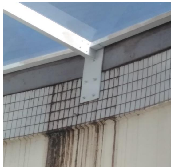
Foto 13 – Detalhe de infiltração de água pela cobertura da cúpula
