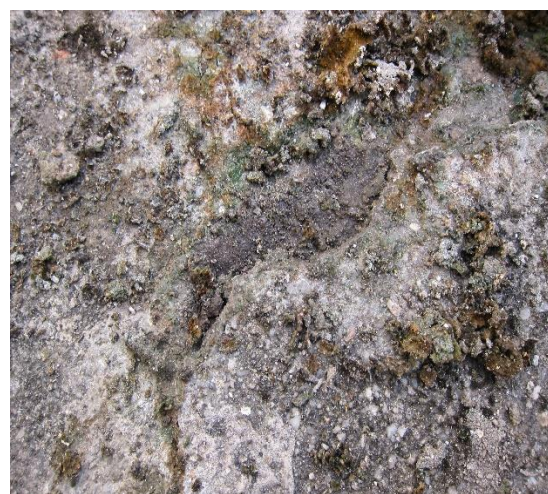
Foto 27 – Perdas de seção e manchas de umidade na cobertura cimentícia da laje
